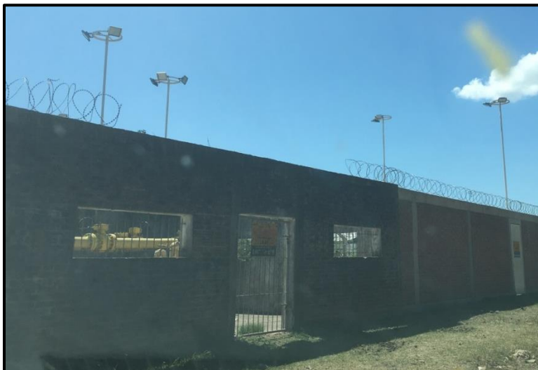
Imagen N° 2.40: Detalle de la Planta de TGS LS-84. La misma se encuentra ubicada de forma aledaña a la planta de Gas Ban.
